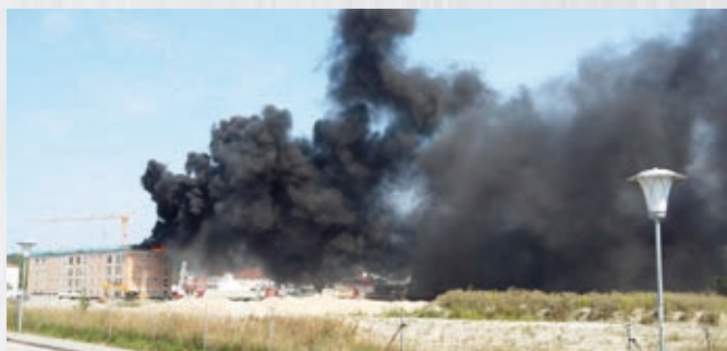
2018-07-18 Brand bei Flämearbeiten auf dem Dach eines Wohngebäudes in der Machlandstraße
