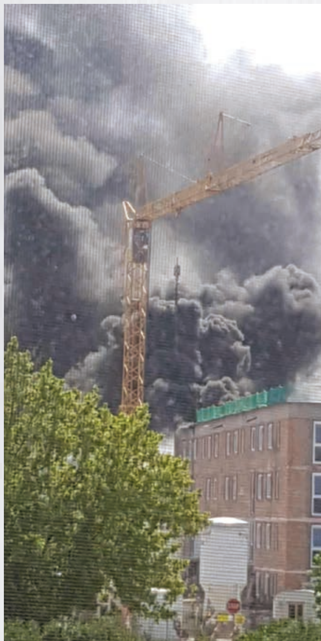
2018-07-18 Brand bei Flämearbeiten auf dem Dach eines Wohngebäudes in der Machlandstraße
